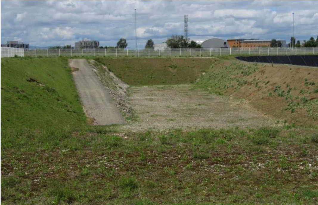
Photo n°5 : bassin de rétention d'eaux de CargoPort, mai 2017, D. TISSIER
