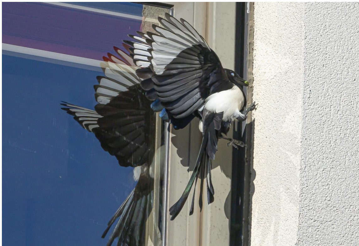
Photo n°1 : Pie bavarde consommant du mastic siliconé, immeuble de l'ARFRIPS, 2 octobre 2025, L. LE COMTE
